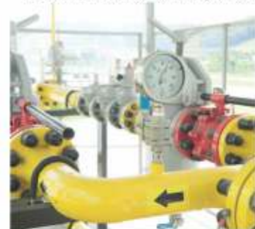
O biometano pode ser distribuído pela rede existente sem necessidade de adaptações.
